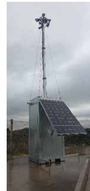
Panel solar único en la torre
