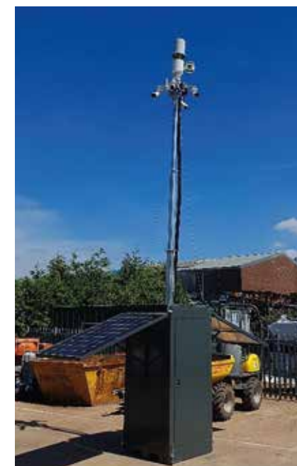
Deux panneaux solaires sur la tour
