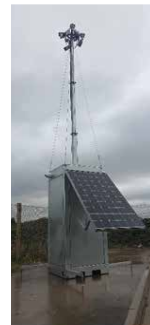
Panneau solaire unique sur la tour
